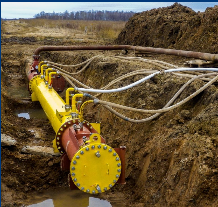
Startovací komora s napojenými přívody vody
