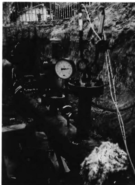
Obr. 5. Pro plynárníka poněkud nezvyklý pohled - ručička manometru ukazuje maximální tlak při prvním cyklu napěťové zkoušky - u potrubí DN 200 PN 25 je to 8,3 MPa!!
