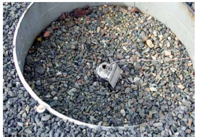
Obr. 2. Teplotní sonda v jímce na potrubí
