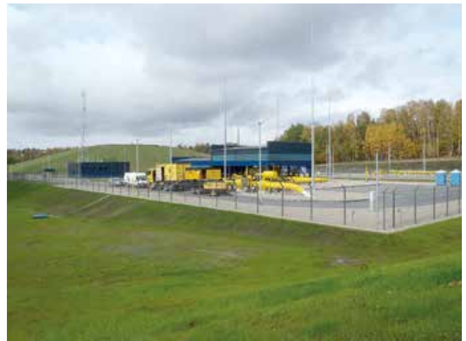
Obr. 2. Předávací stanice (v popředí sušící technologie CEPS – dva kompresory a sušící jednotka)
